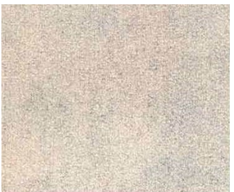
Condition C Blasted to Sa 2,5
