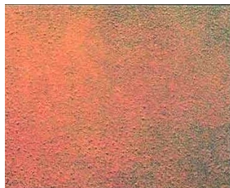
Condition C Blasted to Sa 1
